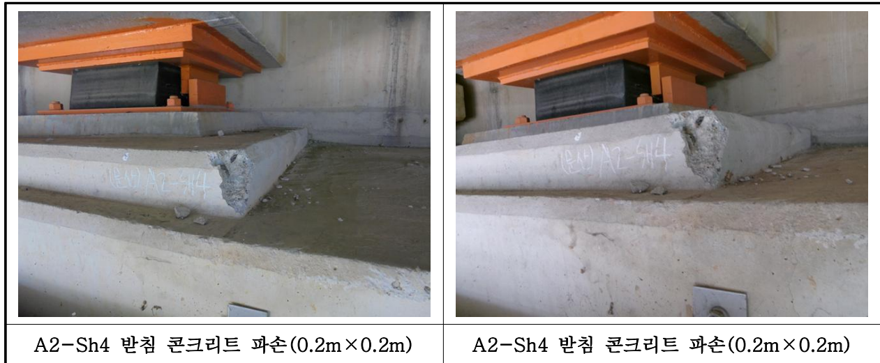
【사진 8.3.13】 교량받침 손상현황
